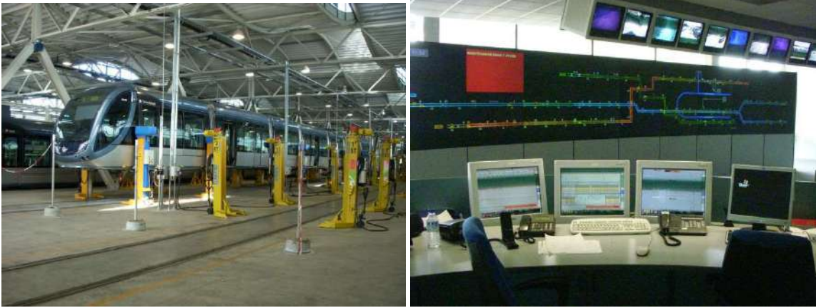
Figura 147: Exemplu de facilități moderne într-un depou cu ateliere de întreținere și Centru de control în Bordeaux, Franța (Sursa: TTK)
