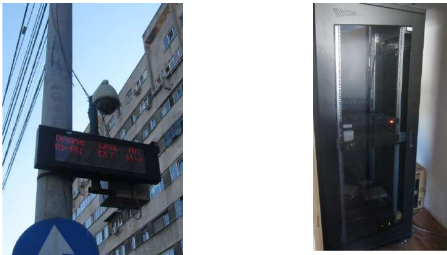
Figura 66: CCTV pentru supravegherea stațiilor de transport public. Server-ul din dispeceratul RAT (fotografie din arhiva proprie)
