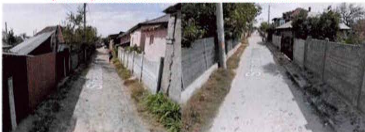
Figura 33. Imagine starea străzilor din categoria foarte slabă și foarte deteriorată
