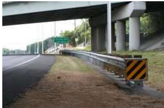
Figura 26: Dispozitive de protecție corespunzătoare (Sursă: Manual de siguranță rutieră pentru Rep. Moldova. Administrația de Stat a Drumurilor, 2011)
