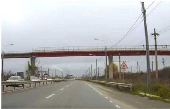
Figura 25: Dispozitiv de protecție periculos, Craiova, Calea Severinului
